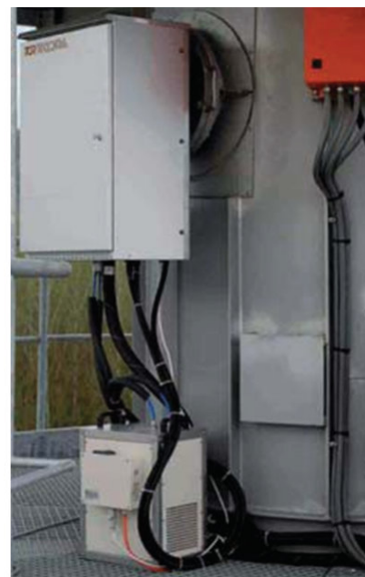
Installazione a camino
