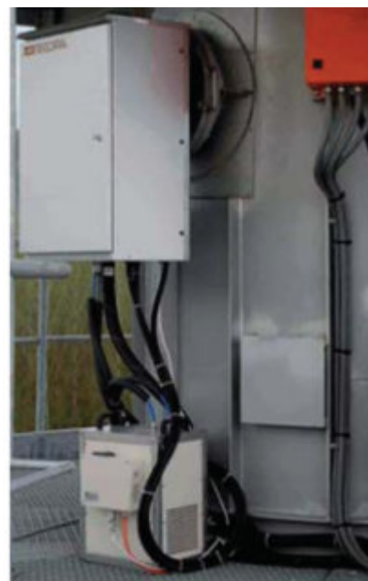
Installazione a camino
