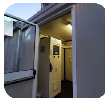
Unità di controllo
