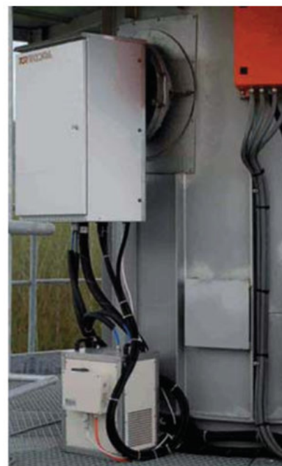
Installazione a camino
